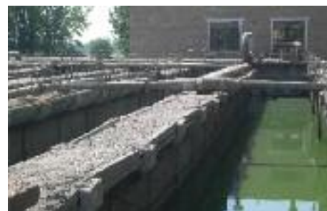
STEP d'Andijan : bassin d'aération à réhabiliter
