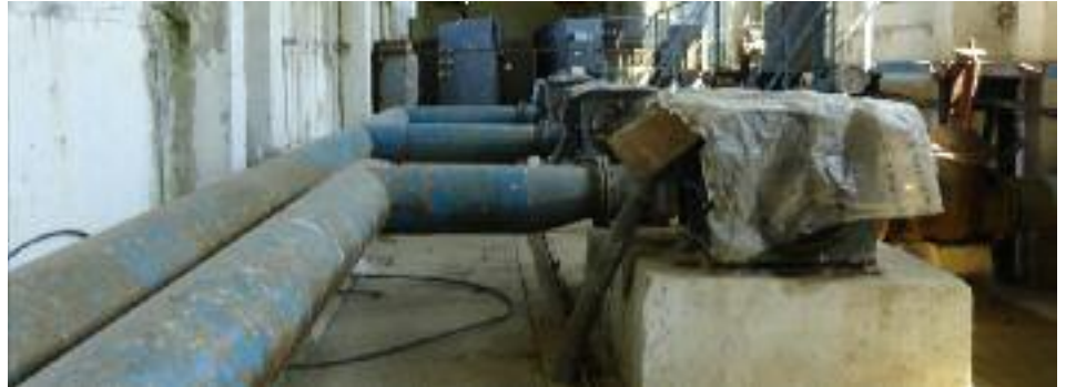
Etat actuel de l'équipement hydromécanique (incluant les moteurs et les pompes)
